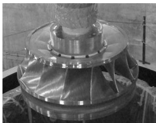
Fig. 6 塚原発電所 フランシス水車
