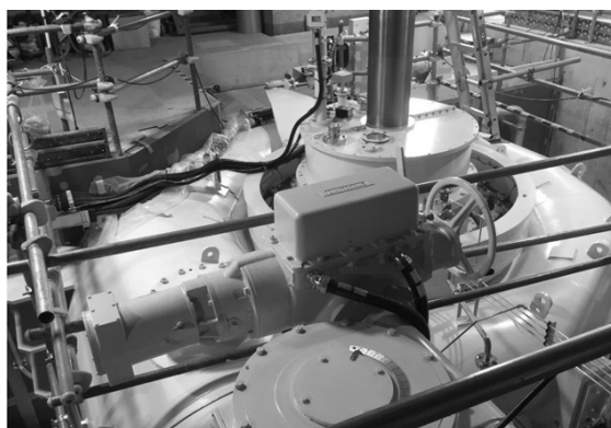
Fig. 4 虻田発電所3号機 フランシス水車
