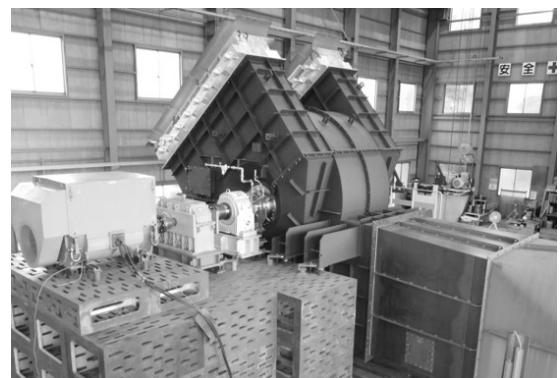
Fig. 8 鉄鋼会社向CDQ用ブロー2,750 kW (日本機械技術)
